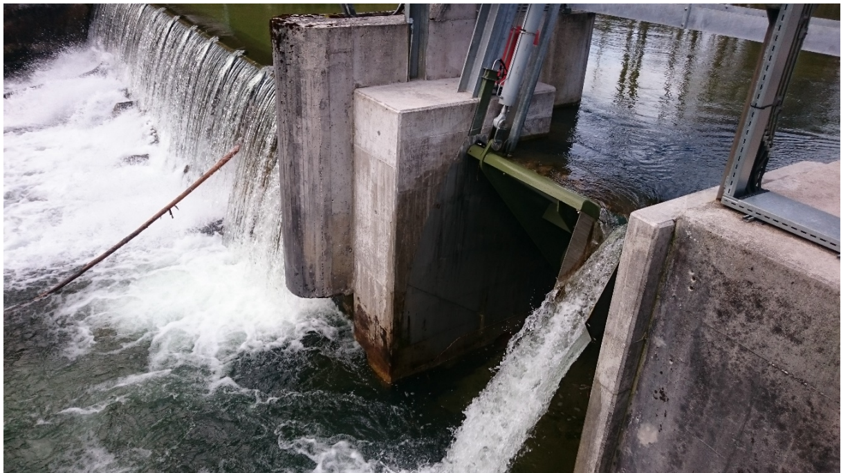
Abbildung 58: Wehrfeld und Fischabstiegsklappe des KW Ebewe. Im Unterwasser des Wehrfeldes sind die Steinschichtungen zur Absicherung der Wehranlage zu erkennen. Aufgenommen am 06. März 2017 bei geringem Wehrüberlauf und einem Abfluss von 10,7 m 3 /s (Tagesmittelwert).
