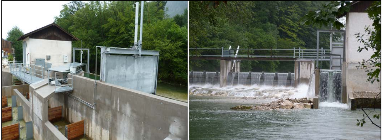
Abbildung 6: links: FAH am KW Laganda, dahinter Zulaufkanal (mit Schütz für Wartungsarbeiten) und Turbineneinzug. rechts: Ansicht KW Laganda aus dem Unterwasser mit Wehrfeld, Treibgutklappe mit Abstiegsklappe und Turbinenauslauf.
