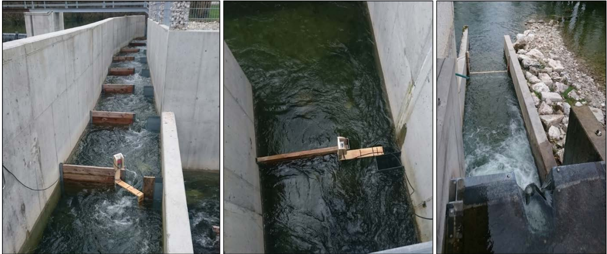
Abbildung 17: Montierte PIT-Antennen in der FAH Laganda – links: Antenne im oberen Bereich (8. Slot), mitte: untere Antenne (26. Slot) – rechts: Abstiegsklappe am KW Laganda mit PIT-Rahmenantenne im flussab liegenden Auslaufkanal.
